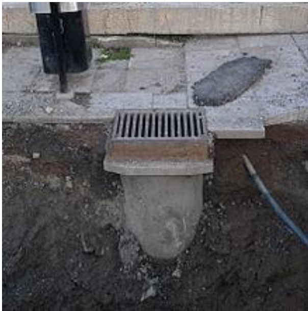
Նկար 21. Փակ ջրհավաք հոր: Storm drain with its pipe visible beneath it due to construction work
